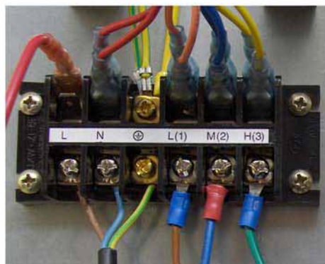
Liaison sur la centrale
